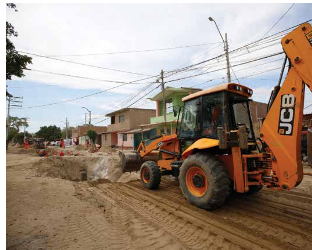
En Piura ya se iniciaron con las obras de rehabilitación de los colectores dañados en Catacaos.
